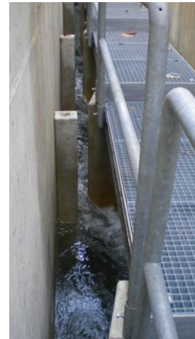
Abb. 3: Becken der Fischwanderhilfe
