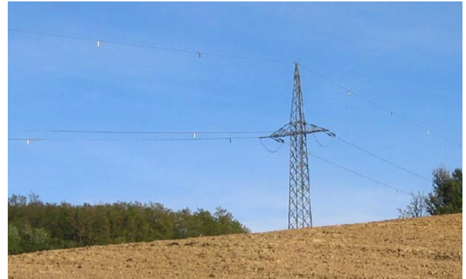
Abb. 4: Mit Vogelschutzfahnen bestückte Bahnstromleitung
